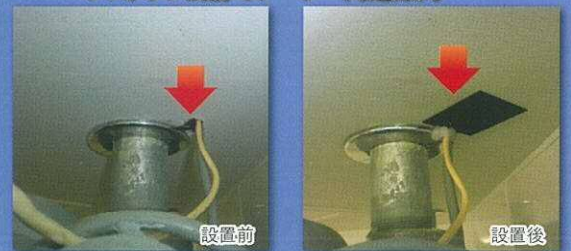
レストラン厨房のメーター周辺隙間
