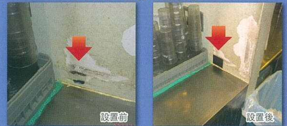
レストラン厨房の壁隙間
